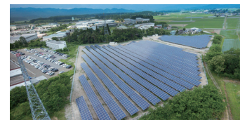
▲秋田県大館市太陽光発電所
