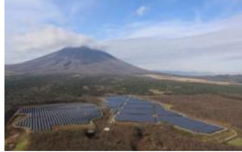
岩手県滝沢 20.8MW
